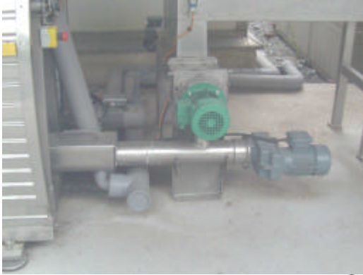
Vue du dispositif de broyage et du déshumidificateur
